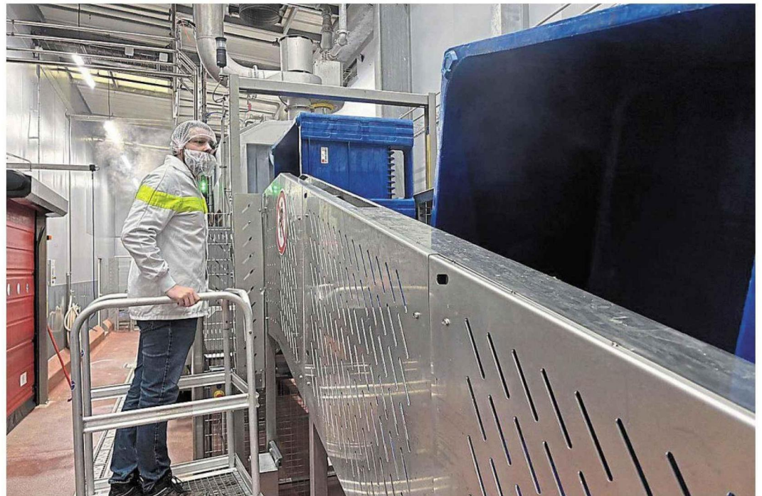
Parmi les actions mises en place par la Normandie pour réduire sa consommation en eau, l'industriel a installé ce tunnel de lavage des bacs, qui remplace le nettoyage manuel au jet. | PHOTO : OUEST-FRANCE
