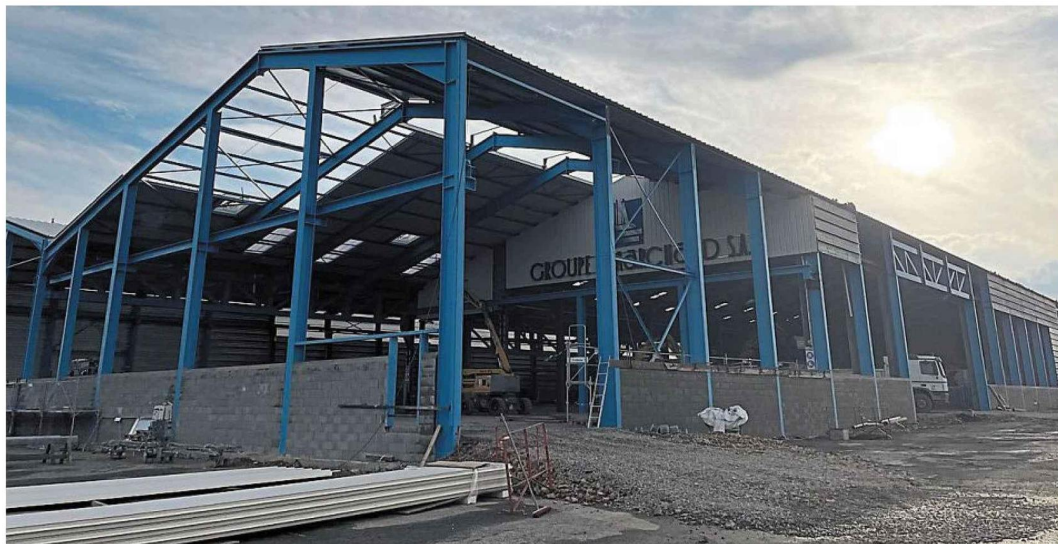
Le Groupe Lemarchand a profité de l'extension de ses ateliers pour installer des panneaux photovoltaïques. | PHOTO : OUEST FRANCE
