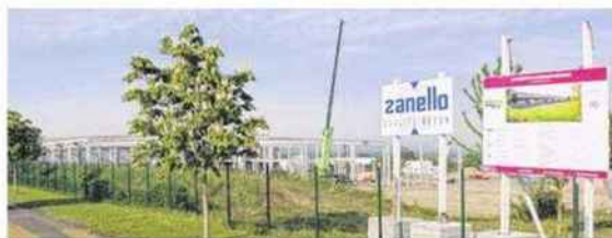
D'une surface actuelle de 9 000 m 2 , le bâtiment de La Normandise situé route de Caen va doubler sa surface.
